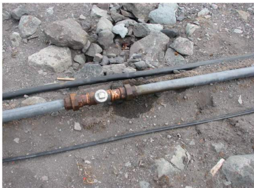
Figura 1.11. Cañerías de transporte de GOA, en la Base Carlini. La manipulación del combustible puede producir pequeños y constantes derrames que contaminen crónicamente el suelo.
